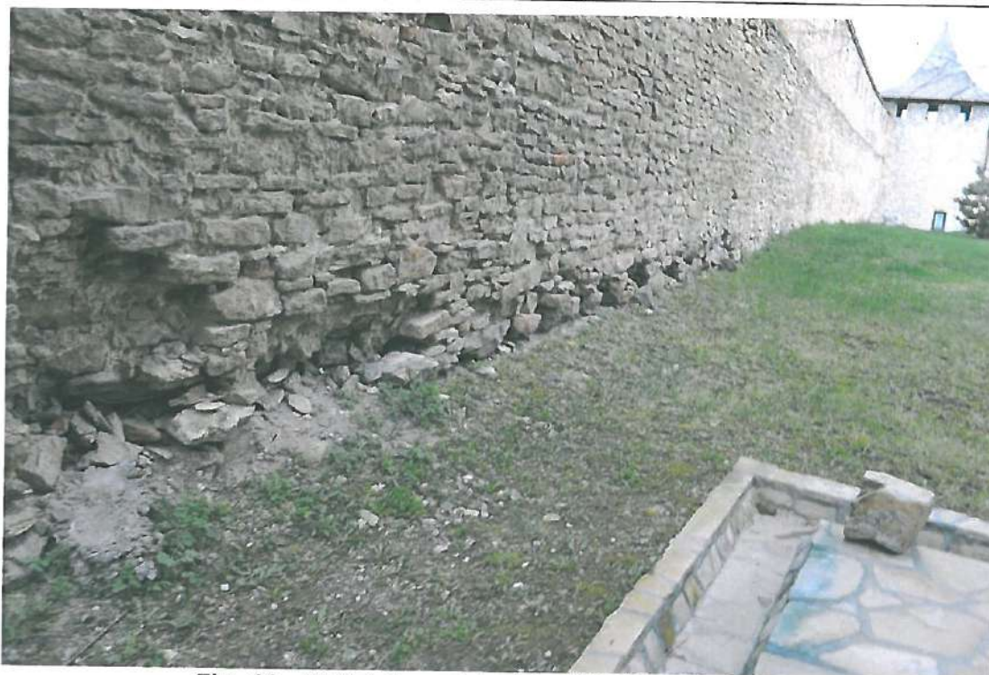
Fig. 44 – Zidării degradate datorită infiltrațiilor de apă
