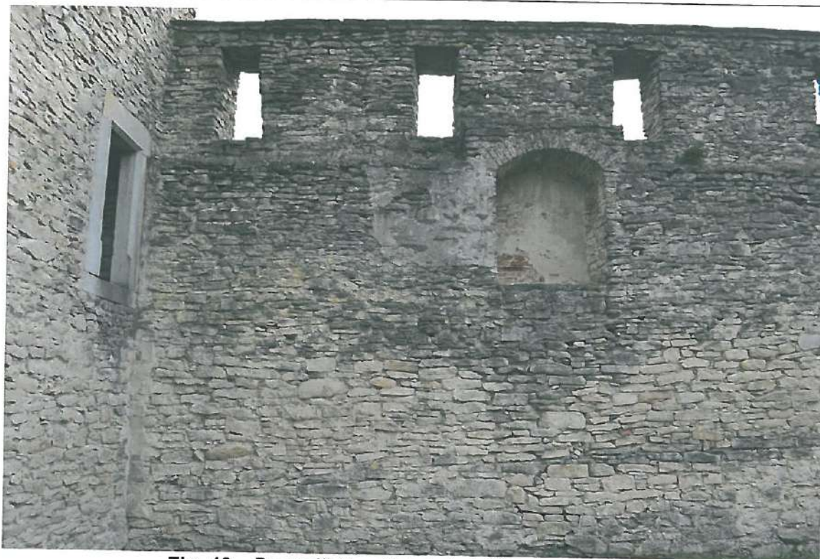
Fig. 48 – Degradări la zidul de incintă pe latura de sud
