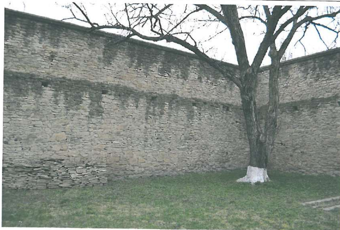
Fig. 42 – Degradări la zidul de incintă
